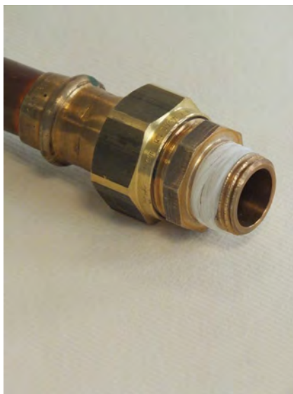
Abb. 10: Rohrleitung mit Dichtfaden
