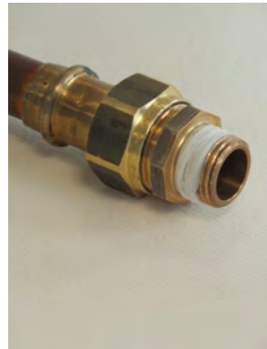
Abb. 10: Rohrleitung mit Dichtfaden
